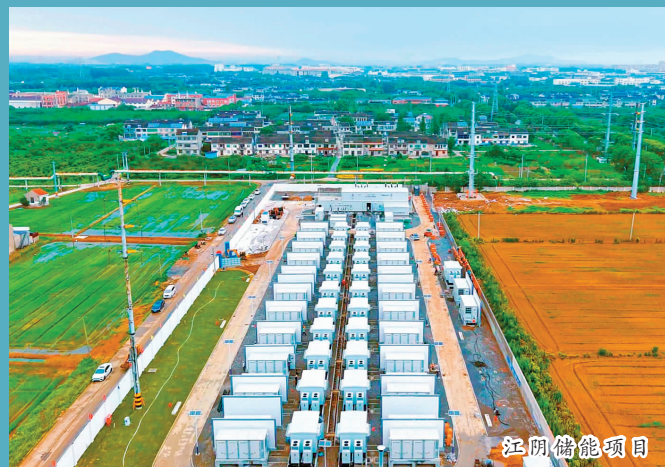
江网储能项目
